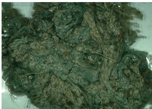
Rys.: Deposition of biofilm in a hotwater storage / Osad biofilmu w zasobniku ciepłej wody
